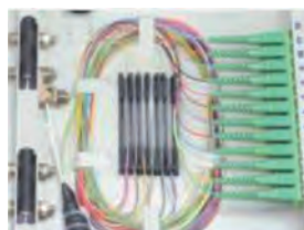
Acomodação dos pigtaills de fusão
