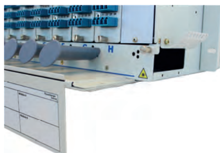
Entrada lateral de cable
